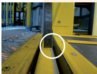
Desnível máximo entre superfícies de 20 mm
